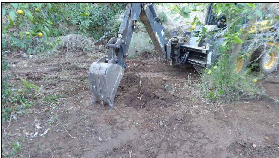
48. Inici de l'excavació de les cales per replantar els arbres de la zona A.
