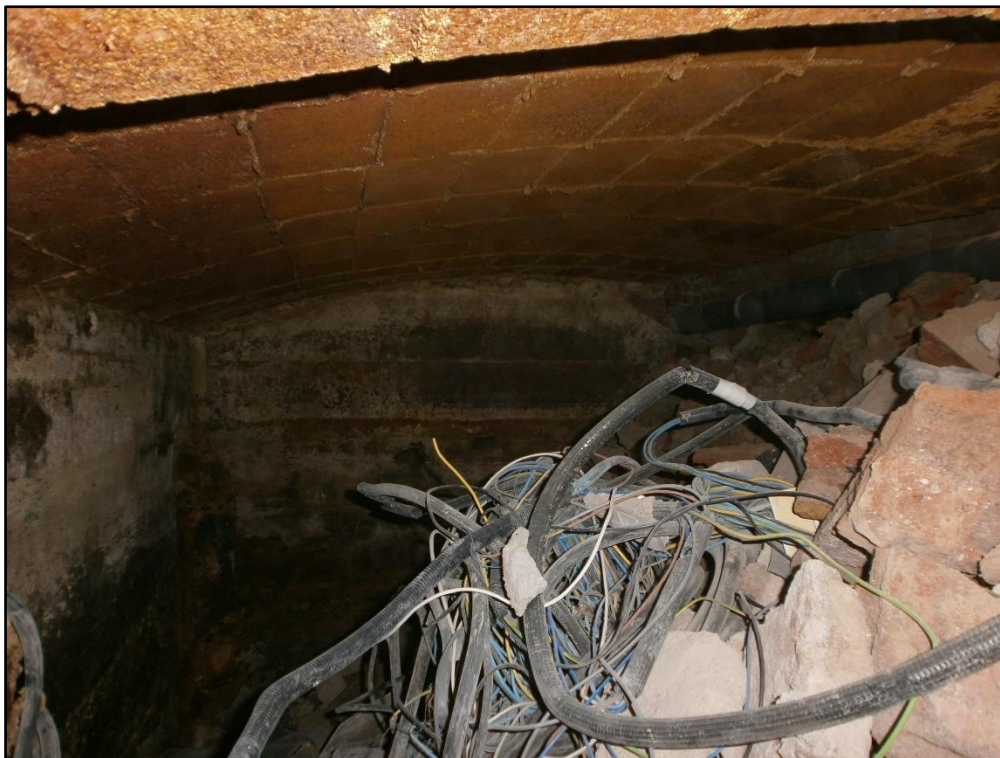
22. Imatge de l'interior de la sala 1, reblerta de runa del segle XX i XXI.
